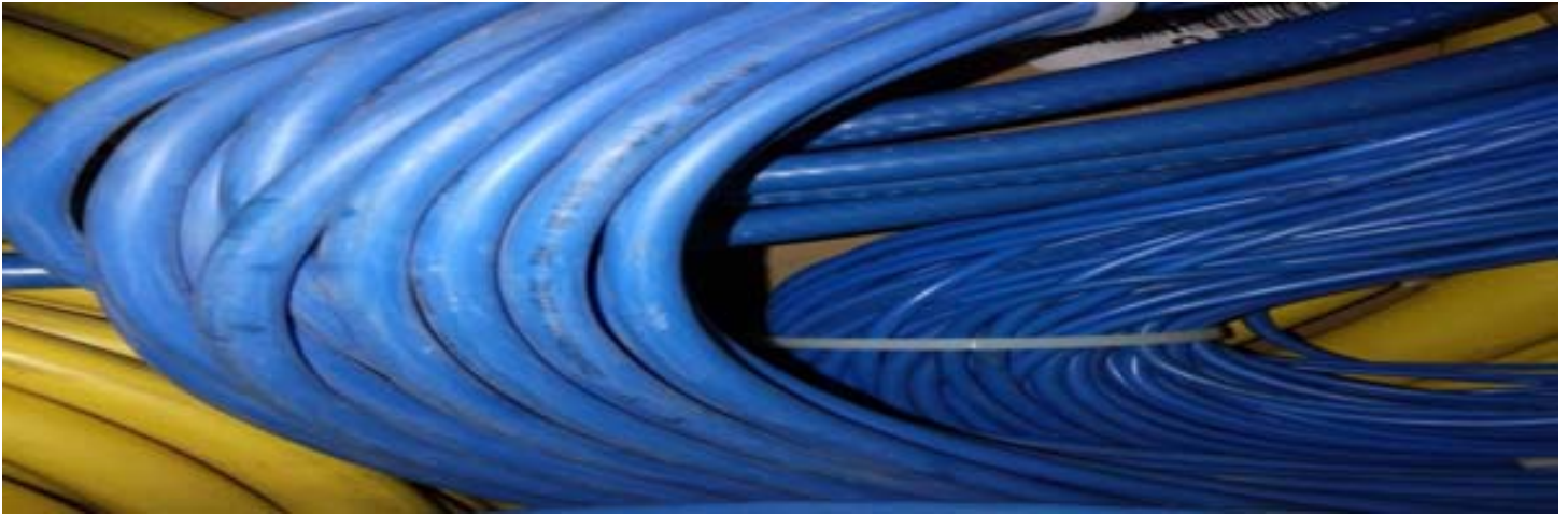
电缆及套管/CABLES
